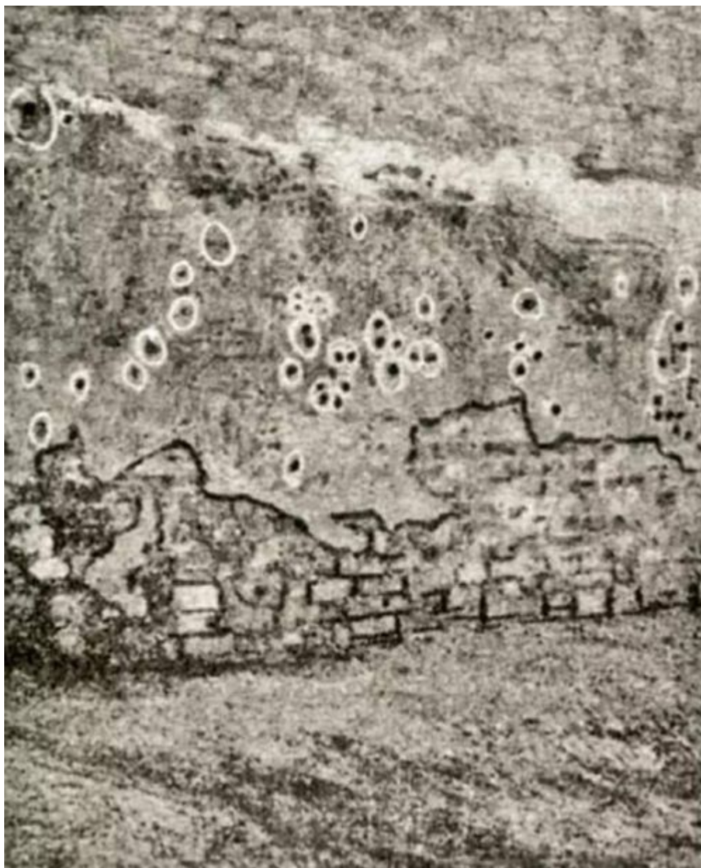
Marcas de balas en los muros de Jallianwalla Bagh, Amritsar, India.
